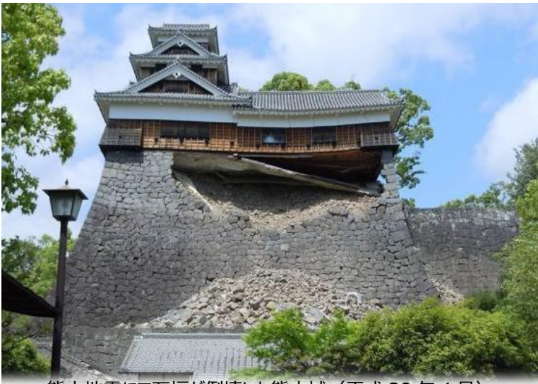
熊本地震にて石垣が倒壊した熊本城（平成29年4月）
